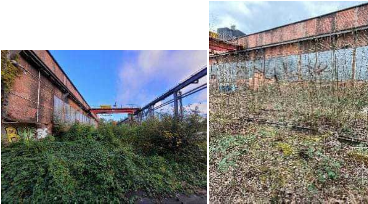
Abb. 2-15: Wand der östlichen Halle, Brombeeren und Gehölzaufwuchs
